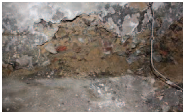
Rys. 5. Uszkodzenia konstrukcji ścian piwnicznych
