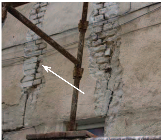
Rys. 2. Uzupelnienie muru cegłą bez przewiązki
